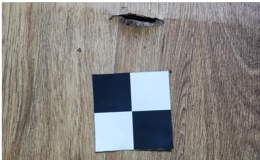
Рис. 2. Эталон в плоскости дефекта линолеума Fig. 2. The reference object in the plane of the linoleum defect
