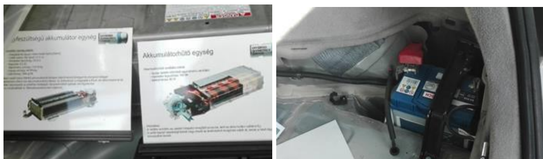
Рис. 9. Высоковольтные аккумуляторы Toyota Prius и устройство для охлаждения аккумулятора (слева) и обычная батарея 12 В (справа) Fig. 9. Toyota Prius high-voltage batteries and battery cooling device (left) and a conventional 12 V battery (right)
