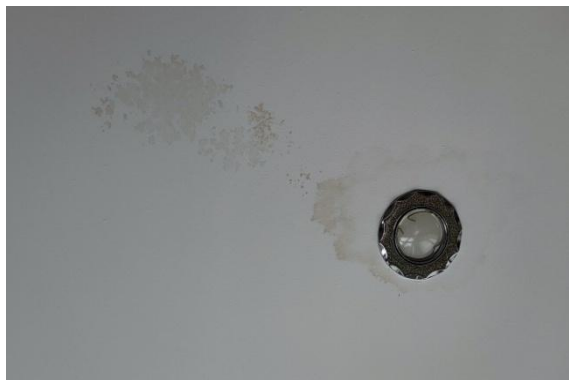
Рис. 2. Следы протечки в первом помещении Fig. 2. Traces of a leak in the first room
