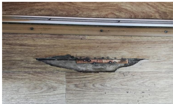
Рис. 4. Порванный линолеум во втором помещении Fig. 4. Torn linoleum in the second room
