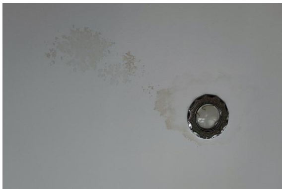
Рис. 2. Следы протечки в первом помещении Fig. 2. Traces of a leak in the first room
