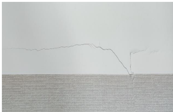
Рис. 3. Трещина в первом помещении Fig. 3. A crack in the first room
